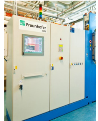
Hybridbeheizte FASTISPS-Anlage (bis Ø 100 mm x 20 mm).
