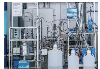
Abb. 3: Finaler Anlagenteil Methanisierung. (Quelle: Timo Lutz | Team für Industriefotografie).
