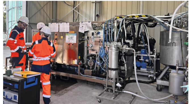
Abb. 2: Pilotfiltrationsanlage bei der Ö Raffinerie Osilub (VITO BE).
