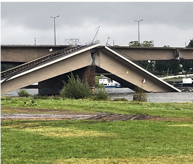
Abb. 1: Einsturz der Carolabrücke in Dresden 2024.
