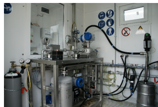
Versuchsanlage für Membranen mit Mehrkanalrohrgeometrien.
