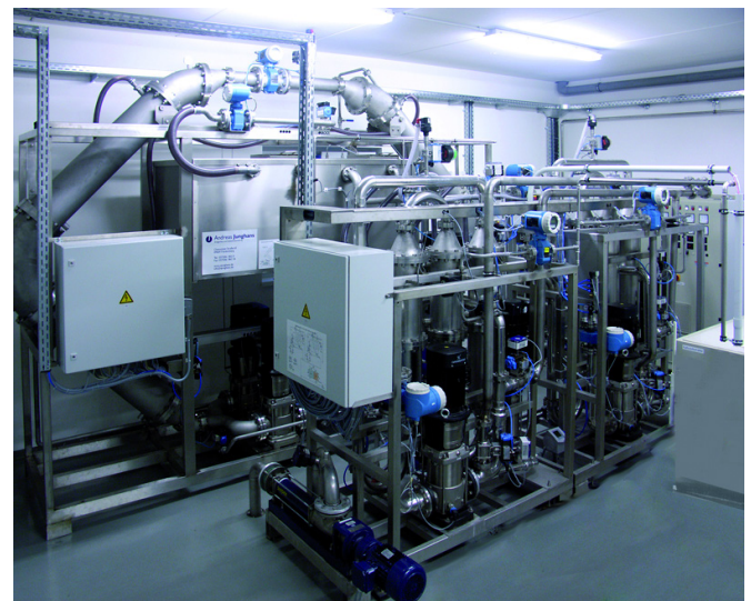
Filtrationsanlage gebaut durch die Firma Andreas Junghans.
